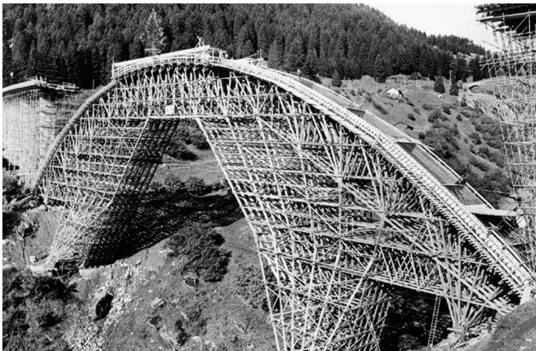
Costruzione di arditi ponti della Strada Nazionale Svizzera N13. Impalcatura per la costruzione del viadotto A13 di Nanin, fra Mesocco e Pian San Giacomo, seconda metà anni '60. Foto: Antonio Rieser dall'Archivio fotografico di Brunetto Vivalda
