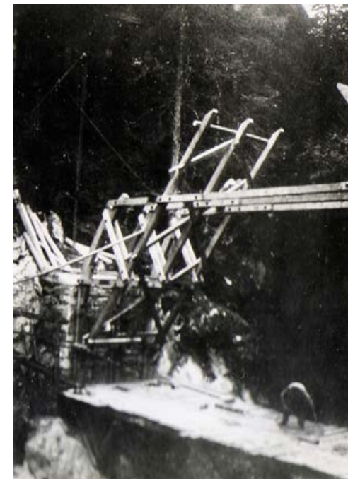
Il basamento in pietra e calcestruzzo è eseguito. Si sta preparando la centinatura
