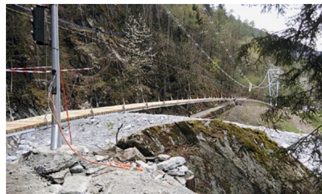
23 aprile 2018, posa del ponte sospeso provvisorio; collegamento fra Promontogno e Bondo, costo circa 300'000 franchi
