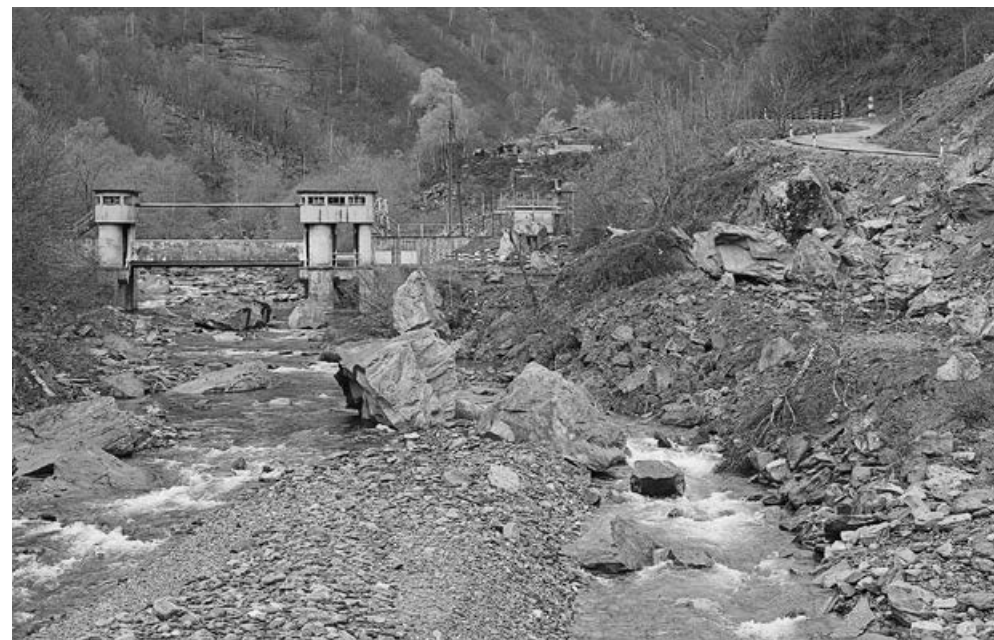
Dopo sei settimane: uno squarcio del nostro paesaggio mutato. La strada di Buseno, a destra, è sgomberata e rifatta la pavimentazione. Lo stabile della centralina elettrica, sullo sfondo, è in ripristino
