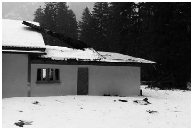
Tetto del poligono 25 m scoperchiato dal vento
