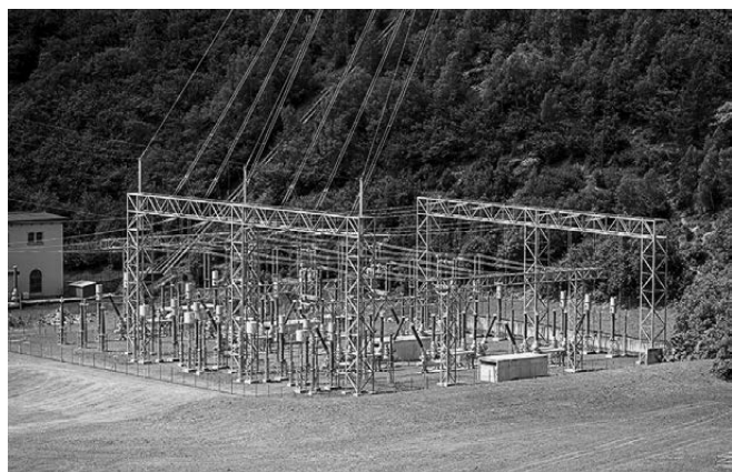
La sottostazione di Robbia è un elemento chiave dell'elettrodotto transfrontaliero Svizzera-Italia
