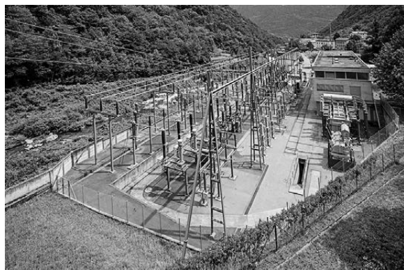
Centrale e sottostazione di Campocologno: l'idroelettrico è la forma di energia più eco-sostenibile
