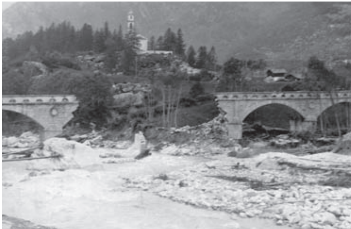
Il ponte alla Palü con due arcate crollate a causa dell'alluvione
