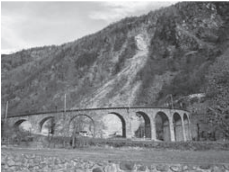
Franamento a nord del viadotto
