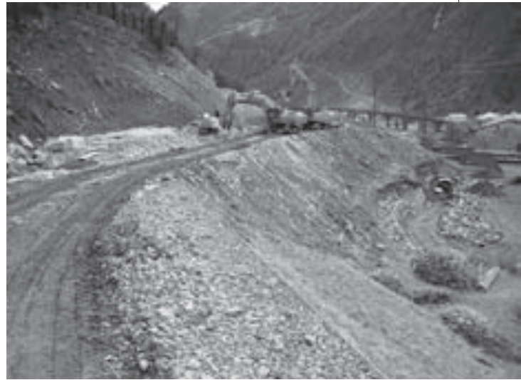
Panoramica della fase di allestimento del vallo. I binari sono stati temporaneamente allontanati
